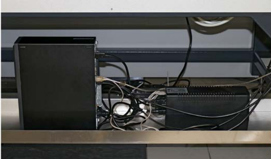
Abb. 9: PC und USV eingebaut
